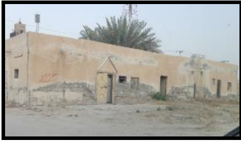
المصدر: تصوير الباحثة، الدراسة الميدانية، سبتمبر ٢٠١٩. صورة (٥) تفكك أساسات المنازل جنوب السبخة
