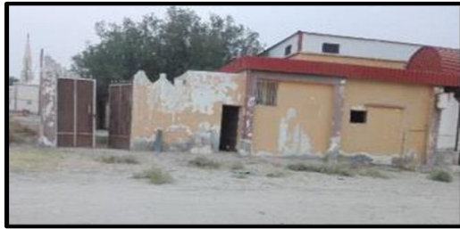
المصدر: تصوير الباحثة، الدراسة الميدانية، سبتمبر ٢٠١٩. صورة (٦) سقوط الطلاء بالمنازل غرب السبخة
